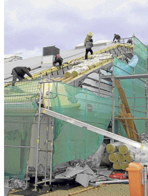
Das Dach und die Fassade der Kreissporthalle an der Lüdertalschule in Großenlüder wurden für 1,15 Millionen komplett saniert. Die alte Dacheindeckung aus Faserzementplatten einschließlich Unterkonstruktion und Dämmung wurde demontiert. Das Dach und die Fassaden erhalten Verkleidungen aus Aluminiumelementen, es werden Türen und Fenster sowie die Toilettenanlagen für die Besucher erneuert.
