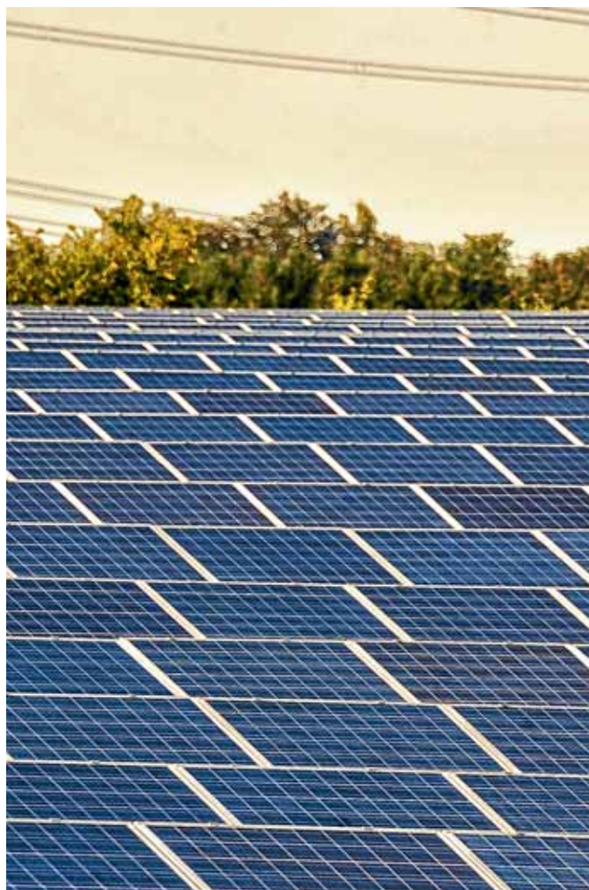
5.568 polykristalline Module, die mit 116 Wechselrichtern verschaltet sind, erzeugen jährlich rund 1.127.000 kWh Solarstrom.
