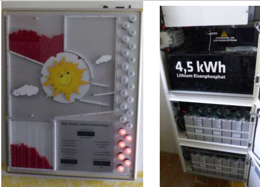
Abb1: Visualisierung (links) und Batteriespeicher (rechts)
